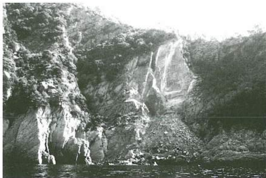
Figura 7 - Località La Valletta: la presenza di fratture suborizzontali, a debole inclinazione verso monte favorisce rotture per flessione nelle bancate arenacee della formazione del Gottero.
