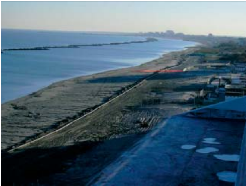
Fase del ripascimento effettuato sui litorali a settentrione di Porto Garibaldi utilizzando per il trasferimento delle sabbie un nuovo sistema di sabbiodotto.
