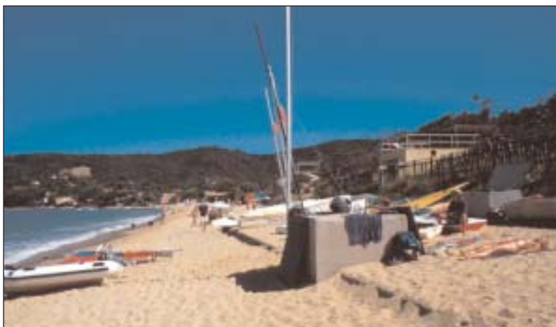
Il litorale di Procchio (Isola d'Elba) in cui si vede il pozzetto della condotta fognaria esposto dall'erosione; lo scaglino sulla spiaggia è dovuto alla presenza del tubo.
