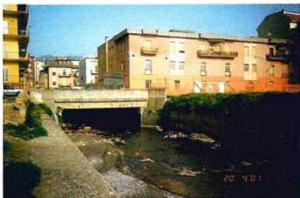
Figura 25 - Asta terminale del Rio Gragnano. Si notano in alveo materiali a granulometria estremamente eterogenea.
