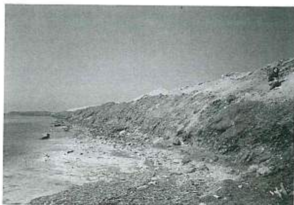
Foto 1 - Falesia nei materiali di riporto in Zona Belleli.
