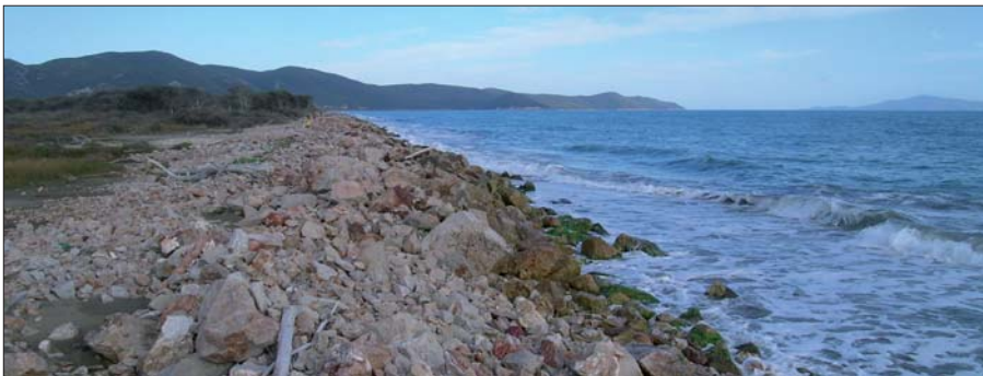
Figura 14 - Vecchio argine di difesa della foce danneggiato per tracimazione ondosa (2006).
