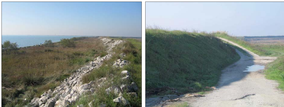
Figura 4 - Argini di difesa a mare in Italia: argine perimetrale della Sacca di Goro (2004). a) a sinistra, lato mare; b) a destra, lato terra.
