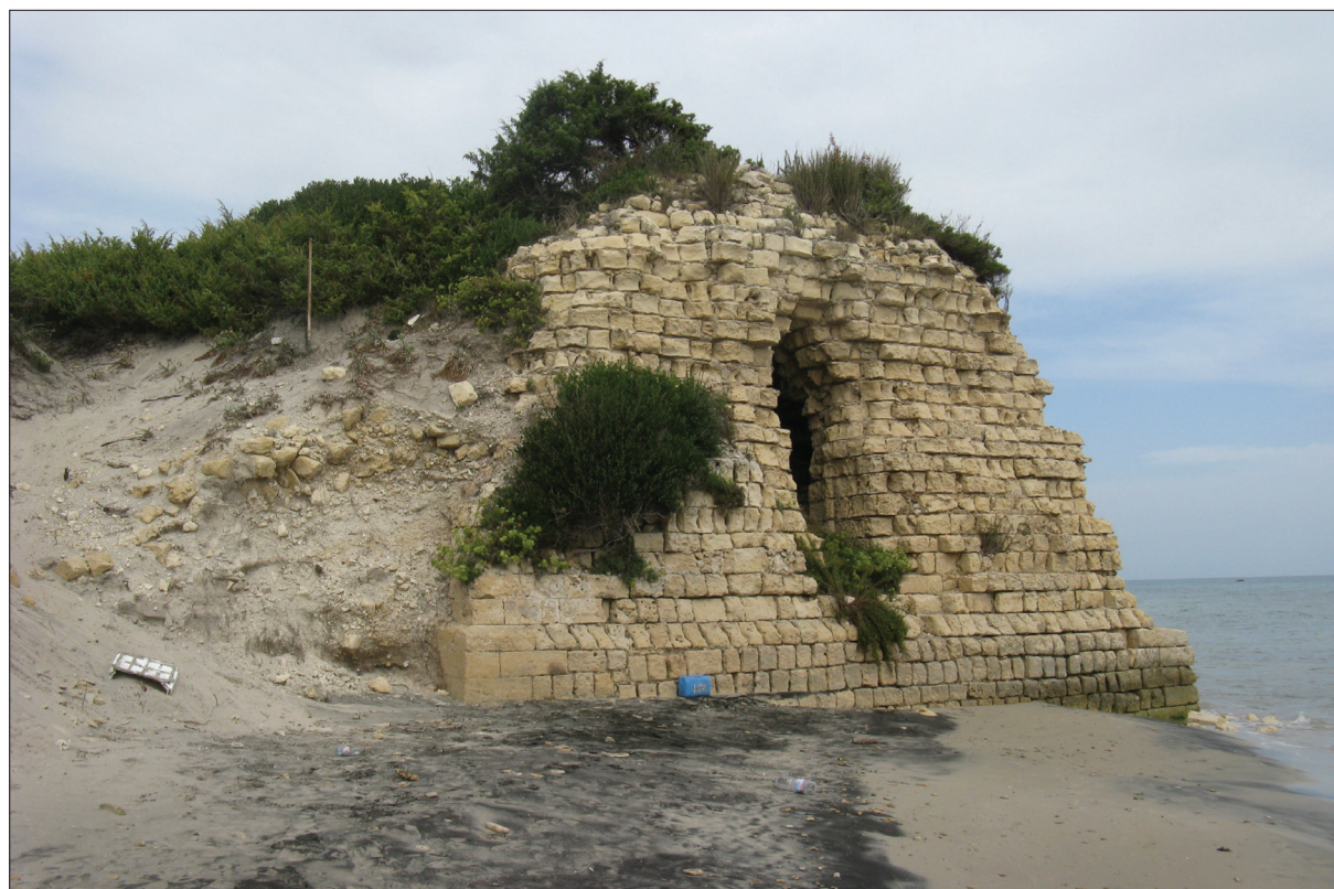
Figura 10 – L'azione delle onde di mareggiata ha posto in evidenza la struttura dei depositi che si appoggiano sui lati verso terra di Torre Fiumicelli. E' ben visibile il corpo di frana, probabilmente prodotto dal terremoto del 20 febbraio 1743. In primo piano sul bordo interno della spiaggia emersa è visibile una concentrazione meccanica di minerali vulcanici di colore scuro provenienti dall'erosione dell'edificio vulcanico del Monte Vulture.
