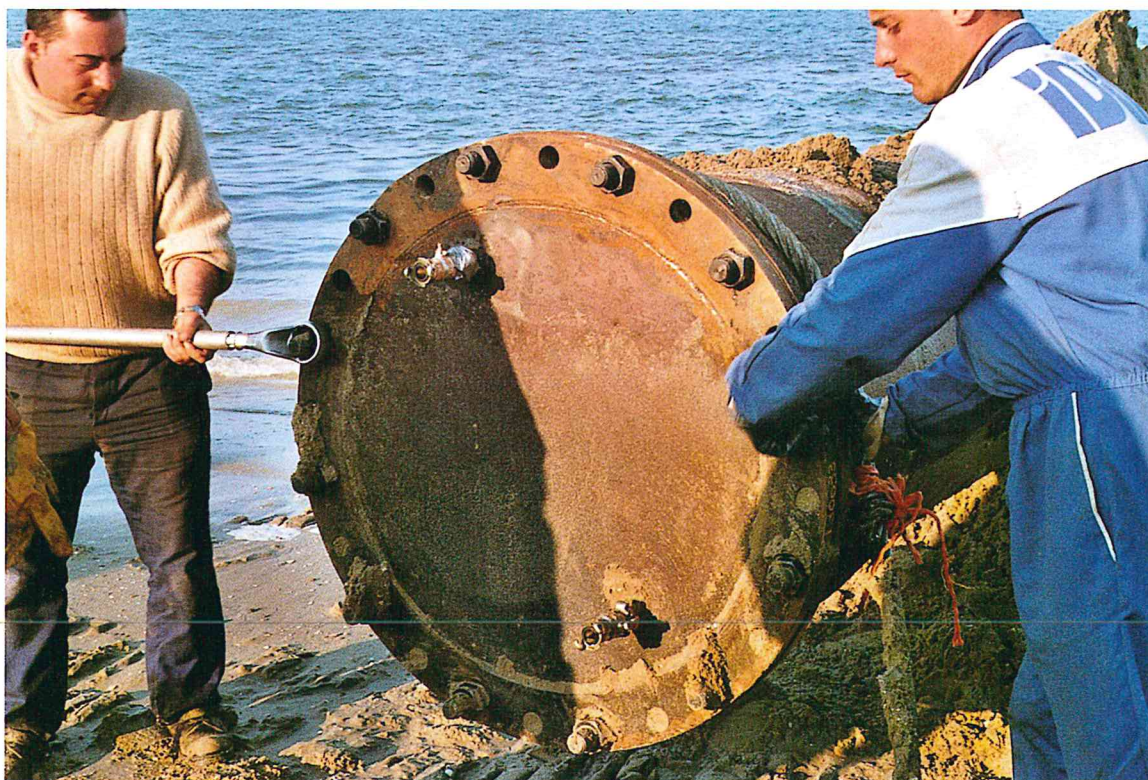
Figura 9 - In alto: tubazione pronta per il varo sulla spiaggia di Cervia; in basso: piastra di chiusura degli estremi della tubazione per renderla galleggiante.
