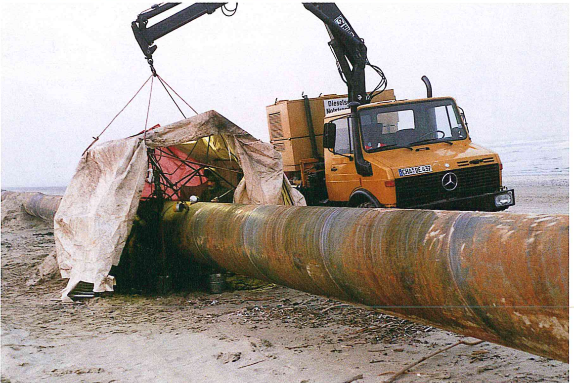
Figura 8 - Spiaggia di Cervia: in alto, distribuzione lungo due linee dei singoli tubi; in basso, struttura mobile adibita alla saldatura dei singoli elementi.
