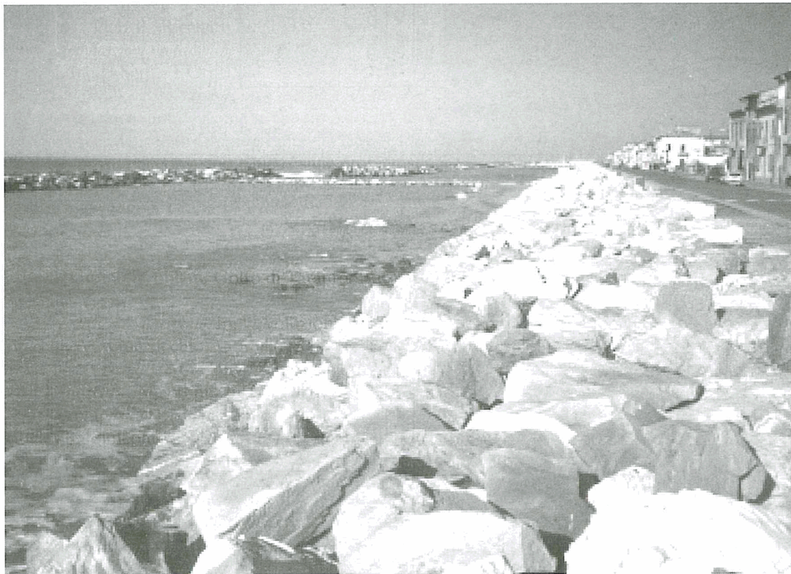
Figura 1b - Vista delle opere di difesa nel tratto centrale dell'abitato di Marina di Pisa.
