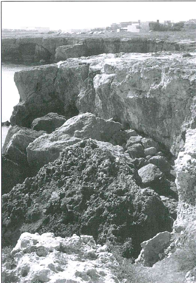
Figura 8 - Distacco recente di blocchi rocciosi e accumulo al piede della falesia (a Sud dell'abitato di Monopoli).
